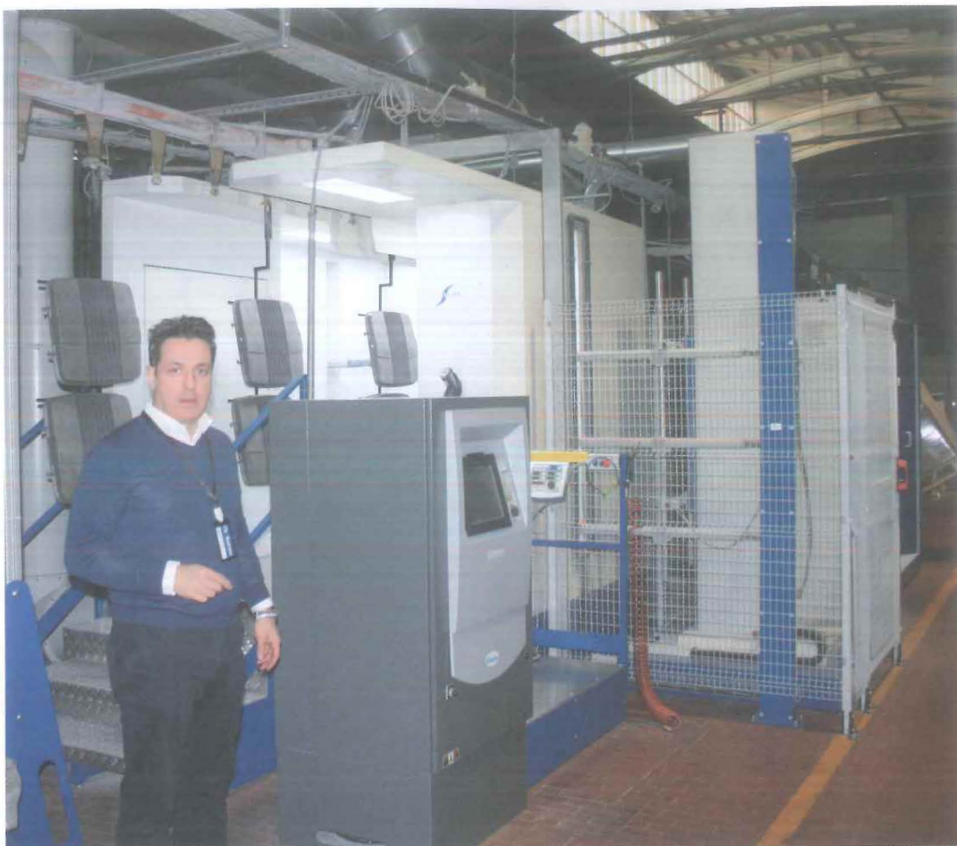
15 - Vista completa della cabina con la disposizione del PLC e, oltre il reciprocatore con 3 pistole Encore, il quadro con le pompe e il letto fluido. A full view of the coating booth with PLC and in addition to reciprocators with three Encore spray-guns, the console with spray-guns and fluidised bed.
